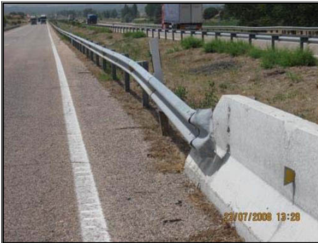
Foto 3: Sistemas de contención mal anclados
