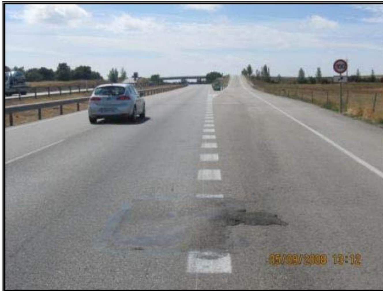
Foto 5: Bache existente en la autovía.
